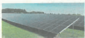
Der neue Solarpark bei Witzmannsweiler. Foto: gm
